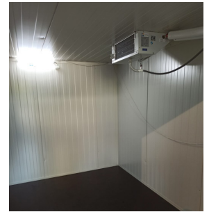
Cold Room with heat exchanger from the inside. Kühlraum mit Wärmetauscher von innen.
