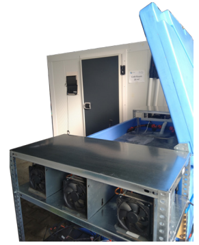
Water Chiller with Cooling Units. Cold Room in the background. Water Chiller mit Kühleinheiten. Kühlraum im Hintergrund.
